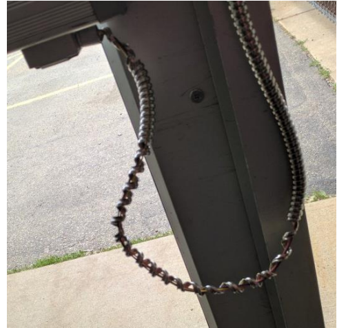
Photo: Door Power Cable
