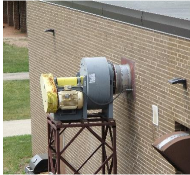
Photo: Shop Exhaust Fan
